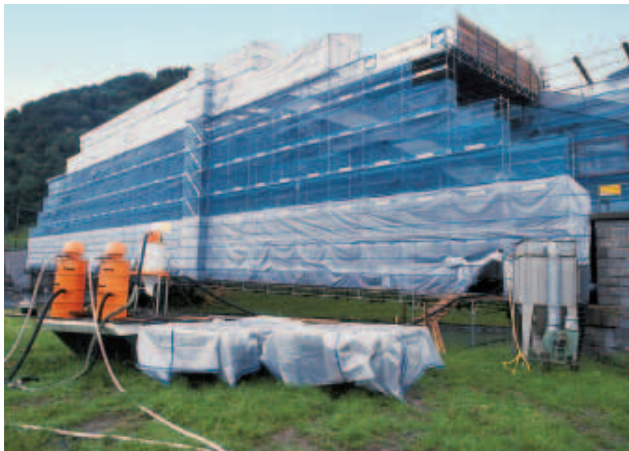
Staubschutzvorrichtung an einer Stahlbrücke. Unten ist die Absaug- und Entstaubungsanlage zu sehen.
